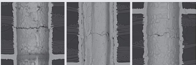
п/отв.1: сквозная трещина по всему периметру в
